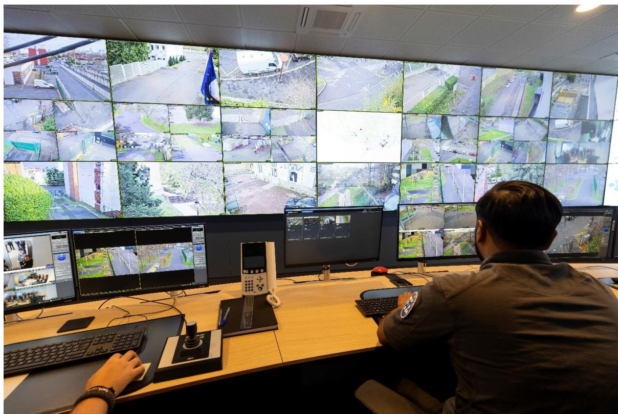
Centre départemental de Supervision du Val d'Oise
